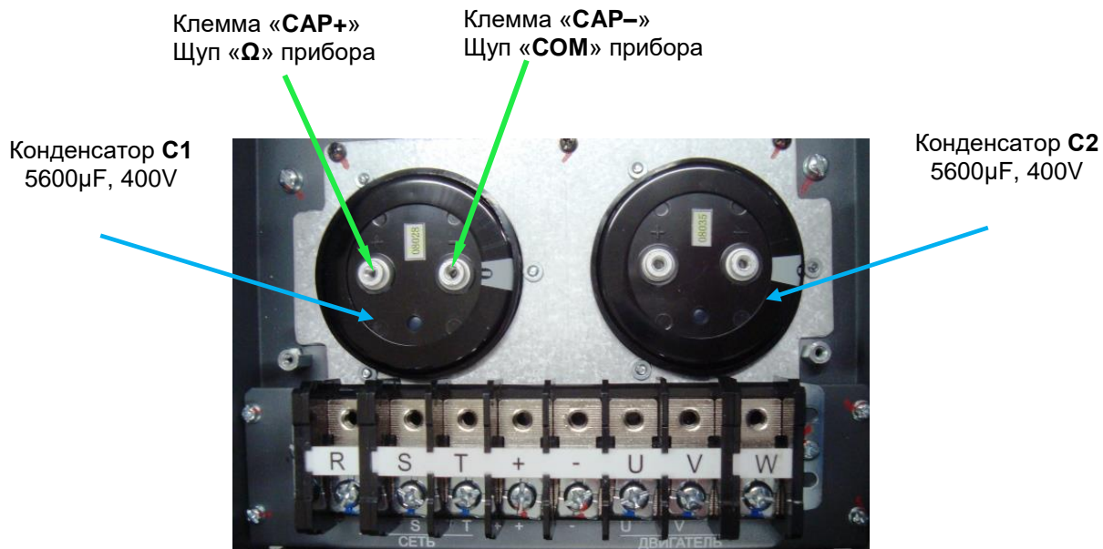
Рис 4.16. Измерение ёмкости силовых конденсаторов.
