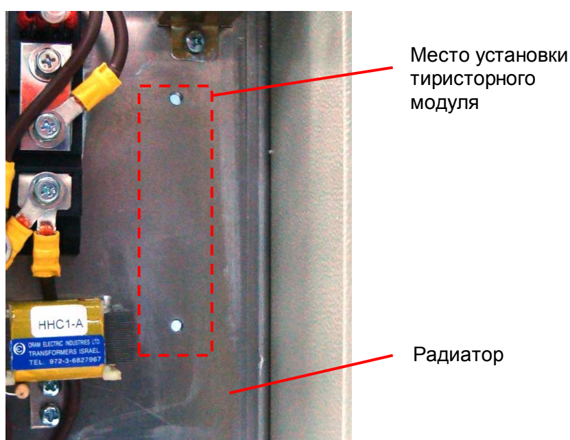
Рис. 7.1. Место установки тиристорного модуля фазы L1.
