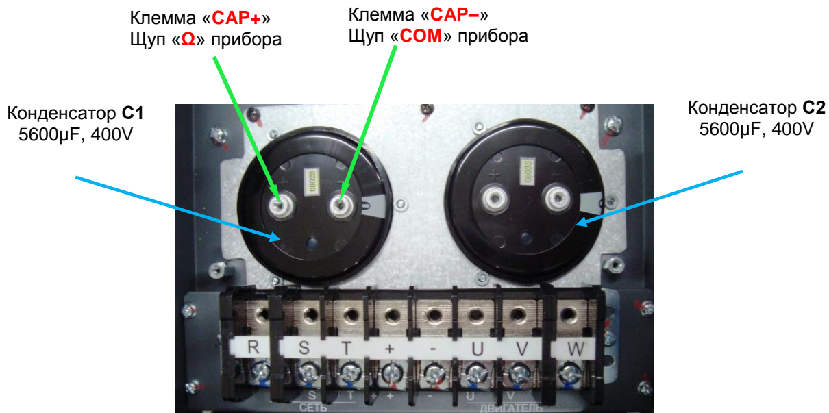
Рис 4.17. Измерение ёмкости силовых конденсаторов.
